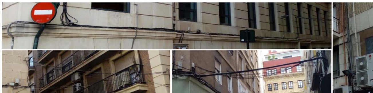
Cableado distorsionador existente en fachadas de edificios del ámbito.
