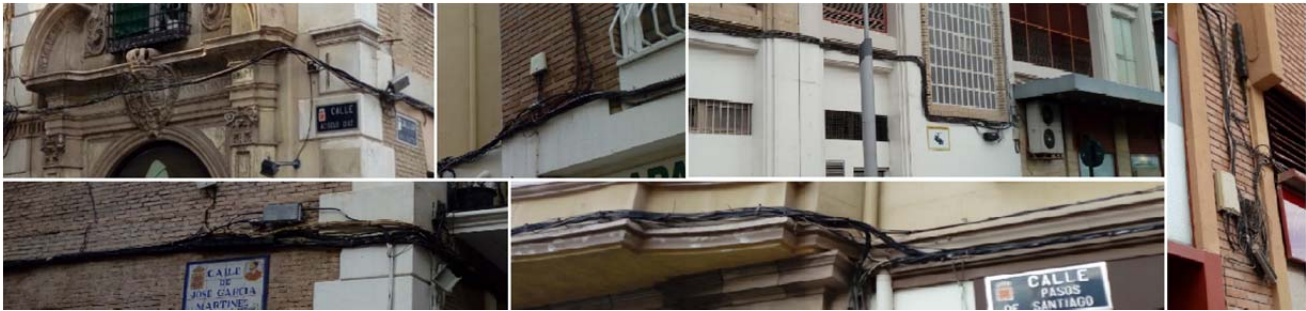
Cableado distorsionador existente en fachadas de edificios del ámbito.
